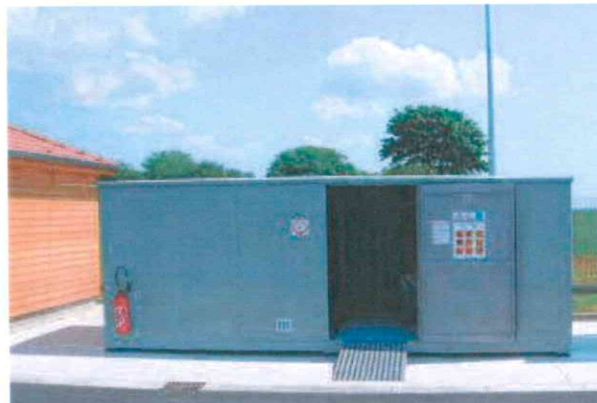
Photo n°2 : Exemple du type d'armoire DDS qui sera mise en place.
